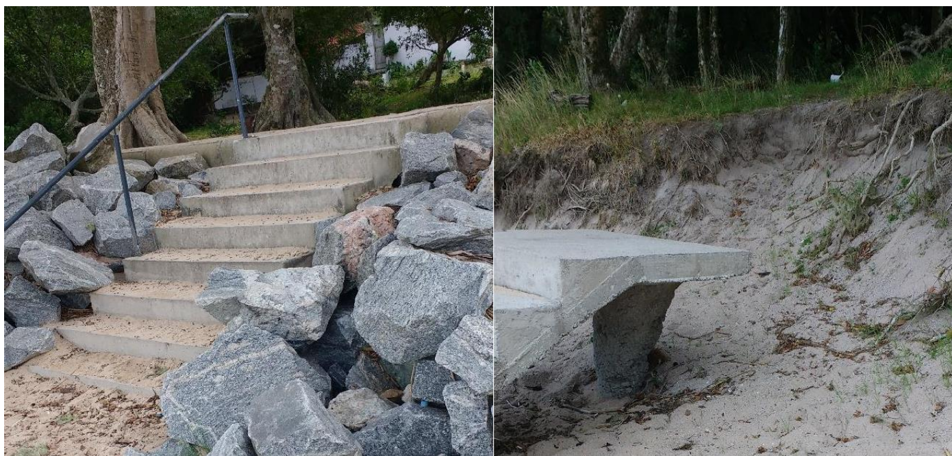
Figura 28: processo erosivo junto às construções.
